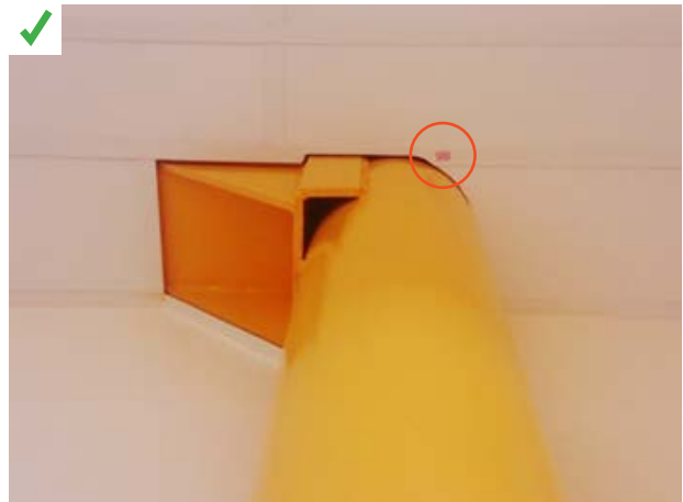
Solution corrective : dans tout le bâtiment, le technicien a repéré par des marqueurs de couleur la position des organes de comptage. L'objectif est de ne pas avoir à déposer plusieurs dalles à chaque contrôle des compteurs. ©AQC
