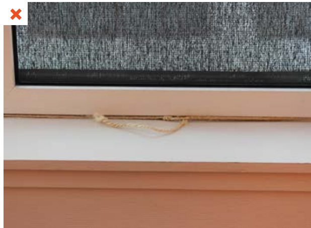
L'automatisation des stores déclenche très régulièrement des cycles d'ouverture/fermeture. Une ficelle a été ajoutée par les usagers afin de maintenir le store fermé. ©AQC
