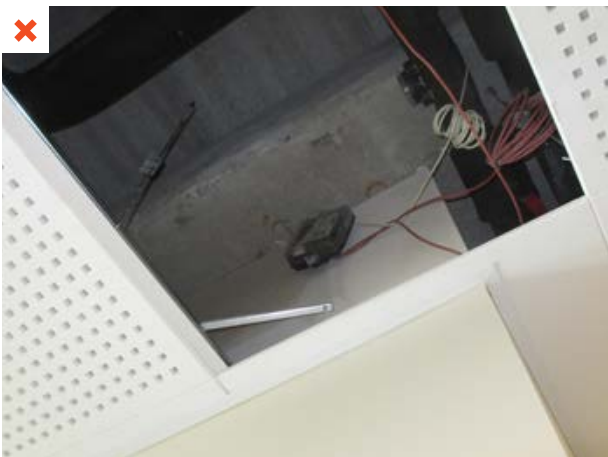
La dalle de faux plafond a dû être cassée pour accéder à un compteur.
